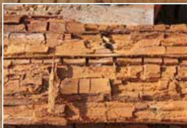
Bruinrot veroorzaakt door huiszwam. Ook kelderzwam veroorzaakt bruinrot.
