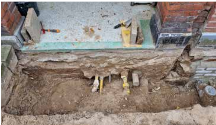
Probleem met loze leidingen bij een huis en hoe het op te lossen
